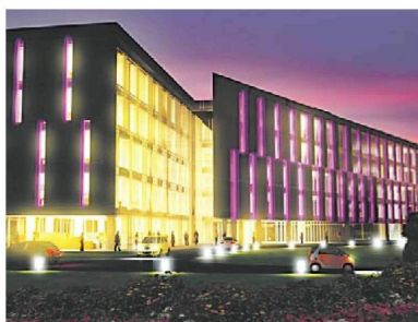
► Przybędzie powierzchni: Przy ul. Hetmańskiej w Poznaniu trwa budowa Skalar Office Center. Oddanie biurowca do użytku zaplanowano na połowę 2010 r. [FOT. ARC]
